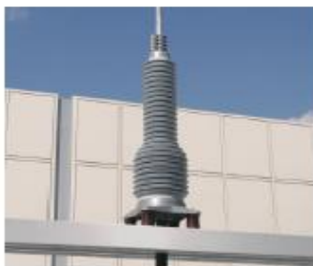
Terminal alta tensión
